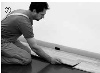
⑦ Start med resten af det afskårne stykke fra første række i den næste række (enderne skal forskydes min. 50 cm). Derved reduceres spildet meget. Lægningen fortsættes element for element. Først drejes elementerne på langs ind i samlingen med et let tryk.
