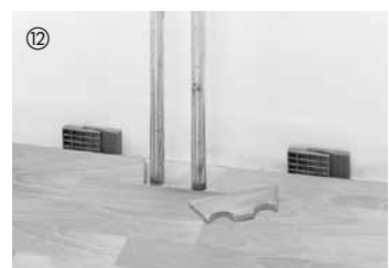
Für aus dem Boden herausragende Heizungsrohre werden in die Elemente Öffnungen (Größe abhängig vom jeweiligen Heizungsrohr und unter Berücksichtigung des erforderlichen Dehnungsabstands) gebohrt oder gesägt.
